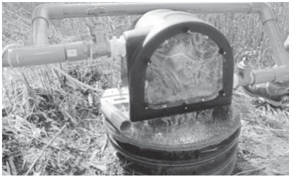
ペルトンマイクロ水力発電機
