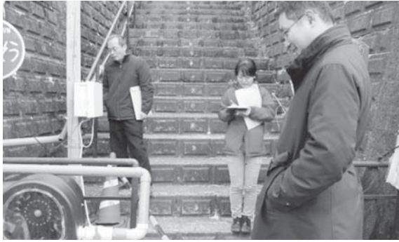
設置された発電機
